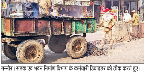
गन्नीर। सड़क एवं भवन निर्माण विभाग के कर्मचारी डिवाइडर को ठीक करते हुए।
